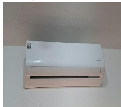
Ar condicionado SPLIT INVENTOR- patrimônio 0593
